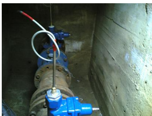
Czujnik szybkości korozji zamontowany na rurociągu
